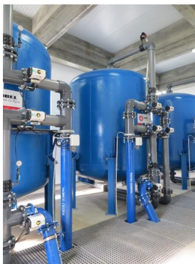
Figura 2 Filtro de areia utilizada no tratamento de águas
